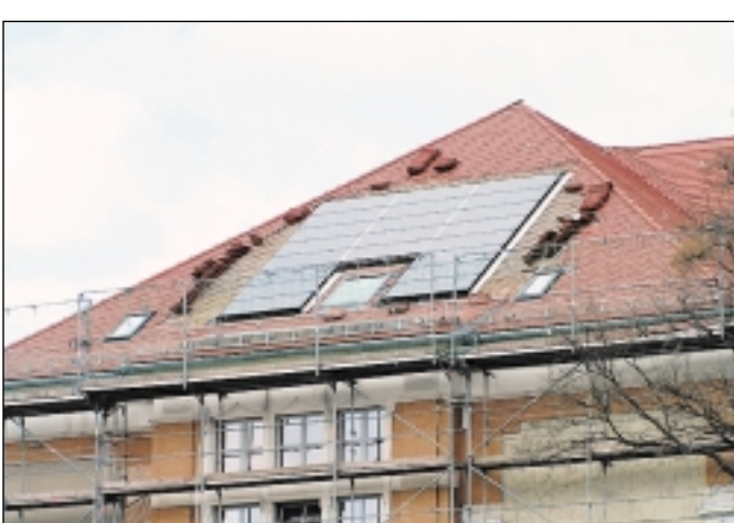
Weithin sichtbar: die Solarmodule auf der Mittelschule in der Dörnerzaunstraße. Foto: Stadtwerke
