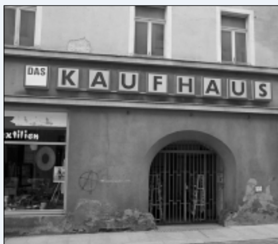
Baubeginn für das neue Kaufhaus in der Petersstraße – dazu muss der Vorgängerbau zu großen Teilen abgerissen werden. Foto: LL
