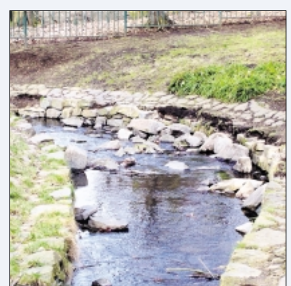
Ärgerlich: Mutwillig zerstörten Vandalen die Uferbefestigung am Goldbach im Albertpark. Foto: Rolf Rothermundt
