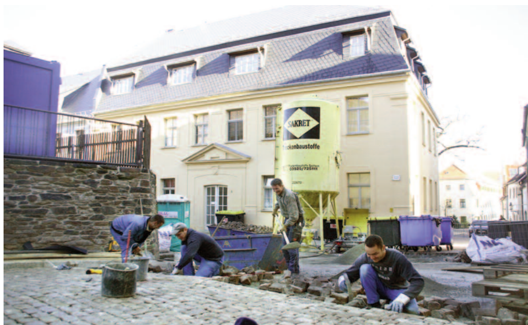
Fast geschafft: Auf der Färbergasse waren die Bauarbeiten Ende vergangener Woche weit vorangeschritten.
