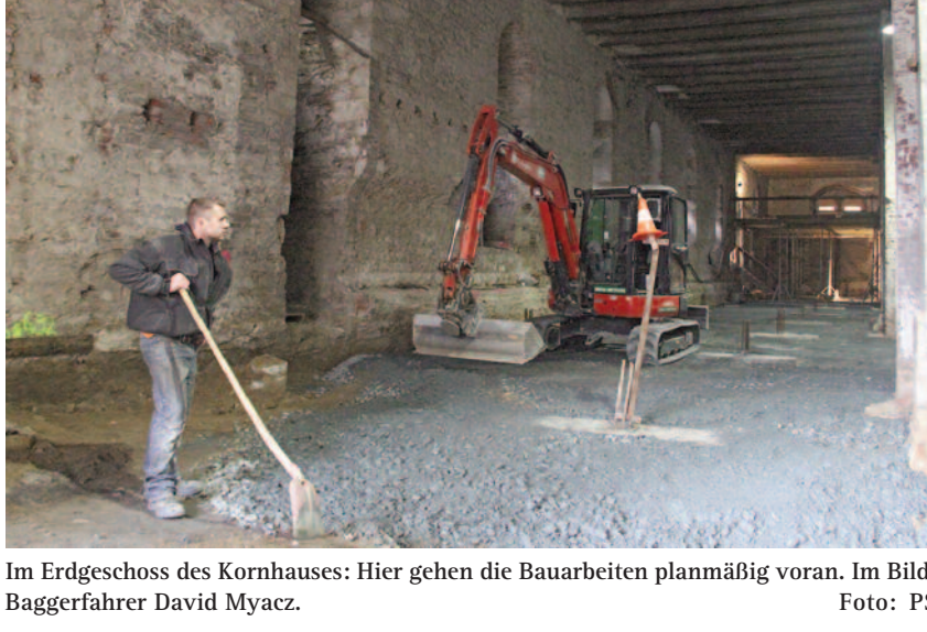
Im Erdgeschoss des Kornhauses: Hier gehen die Bauarbeiten planmäßig voran. Im Bild: Baggerfahrer David Myacz. Foto: PS
