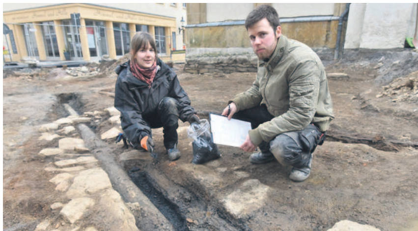
Linda Geiser, wissenschaftliche Volontärin am Landesamt für Archäologie, und Grabungsarbeiter Marcel Burghardt legen auf dem Buttermarkt eine Frischwasserleitung frei. Foto: Eckardt Mildner
