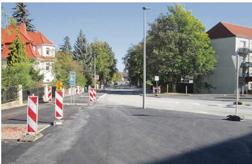
Hier gilt künftig rechts vor links: auf der Goethestraße. Die Sanierungsarbeiten des zweiten Bauabschnittes sind seit Anfang des Monats beendet.
