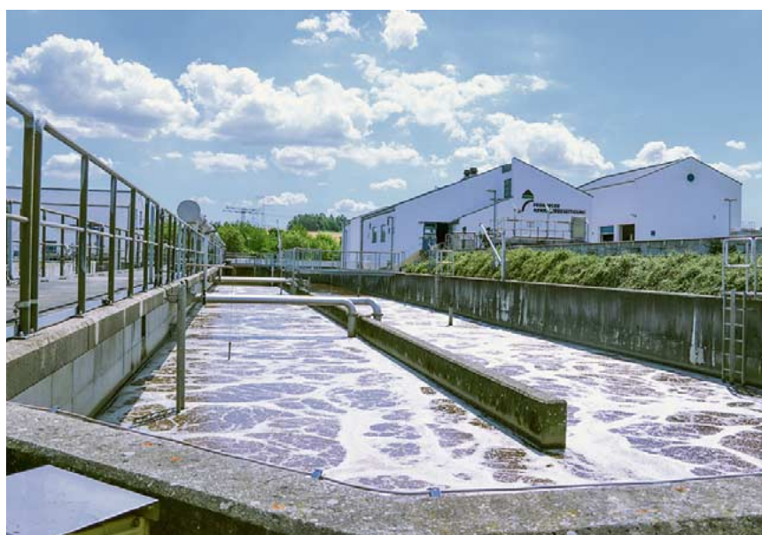
Im Belebungsbecken (112) wird Abwasser biologisch gereinigt. Von hier geht's weiter ins Nachklärbecken (116).
