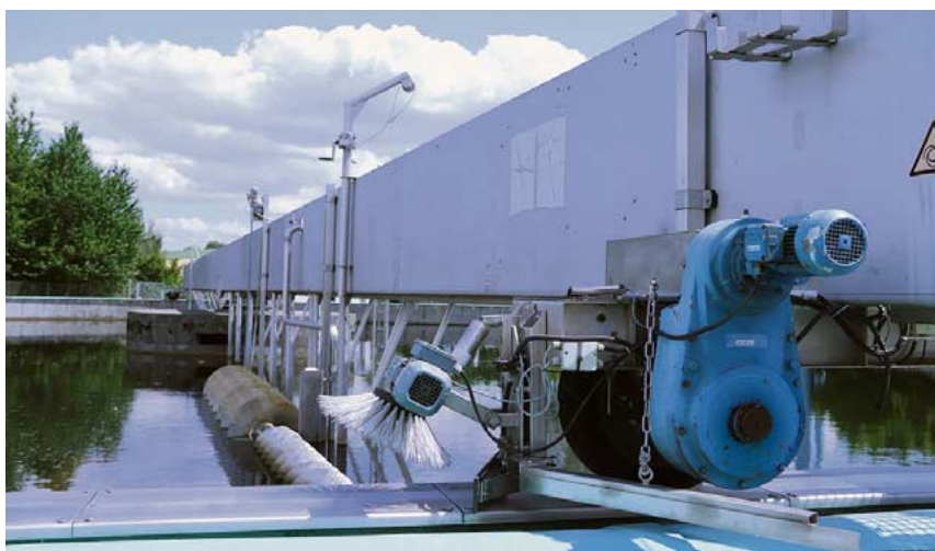
Immer in Bewegung für sauberes Abwasser: die Räumerbrücke auf dem Nachklärbecken der FAB im Münzbachtal. Foto PS
