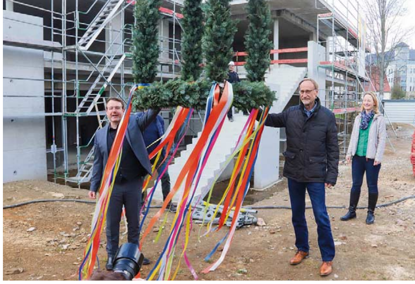
Oberbürgermeister Sven Krüger (l.) ließ gemeinsam mit Bürgermeister Holger Reuter und Silke Grombach, Leiterin des Hochbau- und Liegenschaftsamtes, am 21. April, die Richtkrone in die Höhe schweben.
