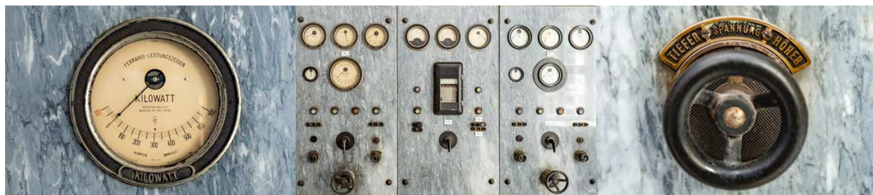
Fotografie dole zleva doprava: Přístroj pro měření výkonu, ovládací prvky a regulátor napětí pro dálkový přenos v hloubce 272 metrů
