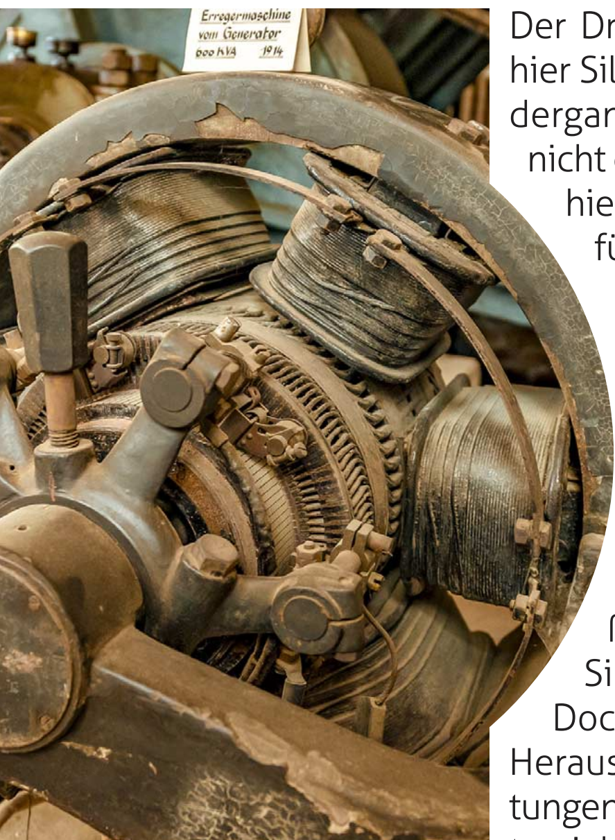
Foto oben: Erregermaschine: Gleichstromgenerator zur Erzeugung des Magnetfeldes im Drehstromgenerator
