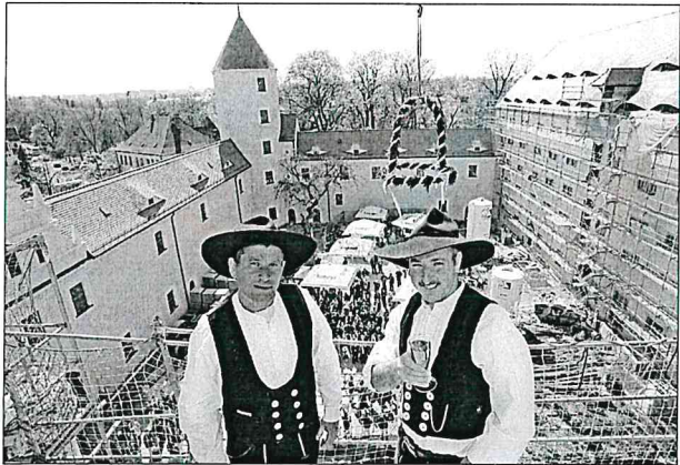
Auf dem Dach des so genannten Kirchenflügels des Schlosses Freudenstein stießen Zimmermann Klaus Steiner (l.) und Polier Mike Michel an. Fotos (2): Detlev Müller
