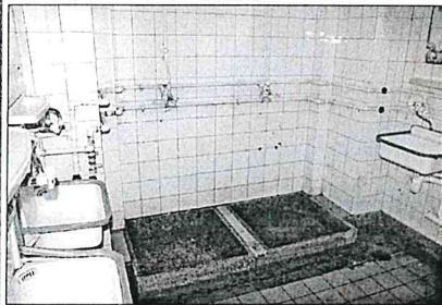
Die sanitären Anlagen der Jahnsportstätte bieten wahrlich kein einladendes Bild. Auch hier muss gehandelt werden. Fotos (2): L. Neuber
