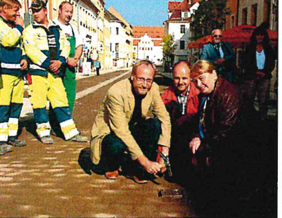
Verlegten gemeinsam den letzten Stein, bevor sie den ersten Bauabschnitt der Burgstraße (zwischen Schlossplatz und Akademiestraße/Thielstraße) für den Straßenverkehr frei gaben: Oberbürgermeisterin Dr. Uta Rensch, Holger Reuter (l.), Dezernent für Stadtentwicklung, und Olaf Thieme, Geschäftsführer der gleichnamigen Tiefbau GmbH aus Dörnthal. Foto: PS
