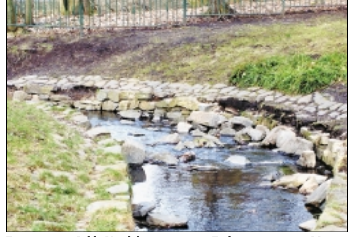
Ein trauriges Bild: Vandalen zerstörten Ende vergangenen Monats die Uferbefestigung des Goldbaches im Albertpark. Foto: RR
