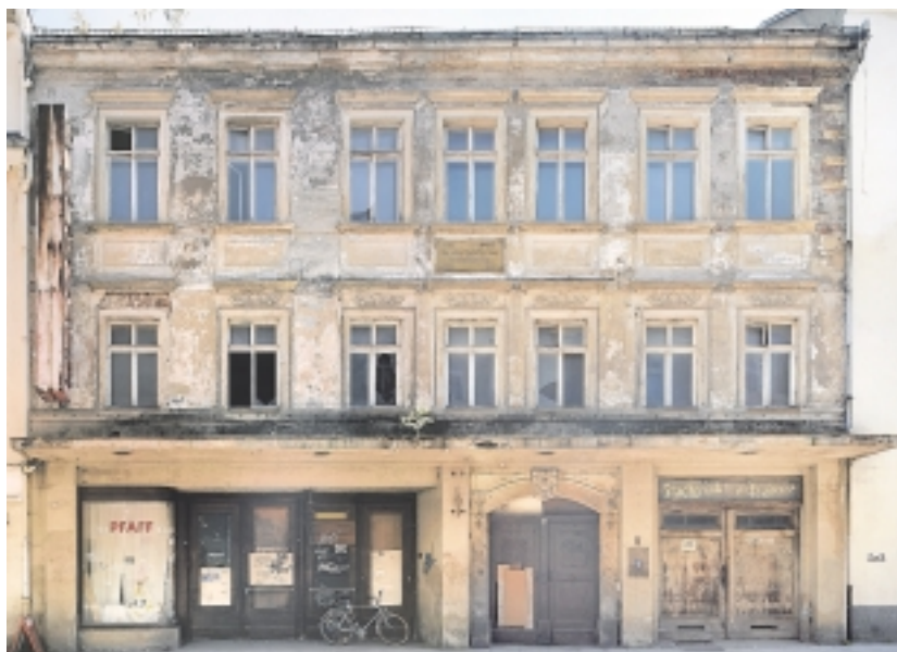
Kein schöner Anblick: das Gebäude Fischerstraße 21. Die Sanierung des Denkmals wäre nur mit nicht vertretbar hohem Aufwand möglich gewesen. Foto: IVD
