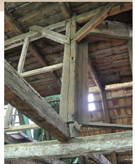
Marode Bausubstanz vor Beginn der Rekonstruktion.
